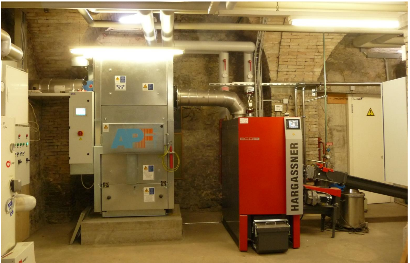
Der Feinstaubfilter nimmt mehr Platz ein als der neue Heizkessel
