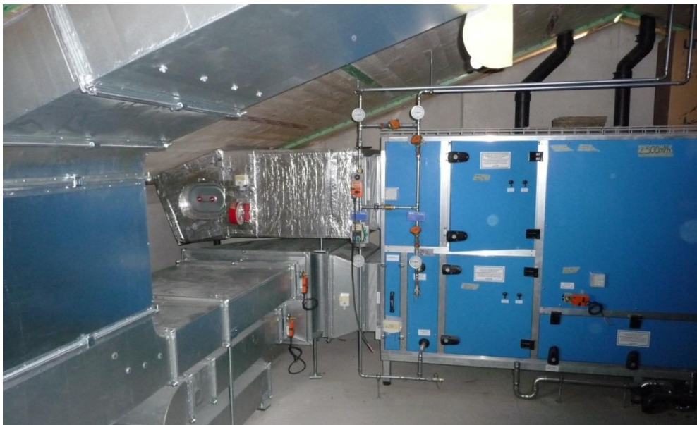
Das Ausmass der Lüftungsanlage über dem Mehrzweckraum ist beeindruckend
